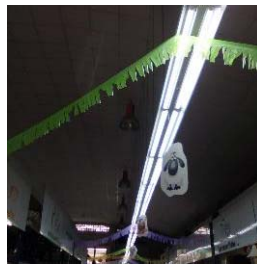
Imagen 6. Luminarias instaladas en el centro
