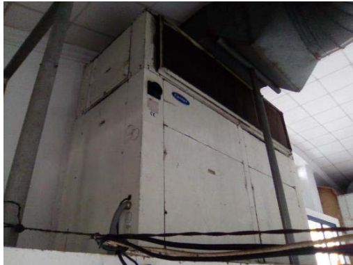
Imagen 8. Equipo Roof-Top para climatización del mercado
