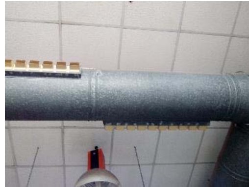
Imagen 9. Conductos de impulsión
